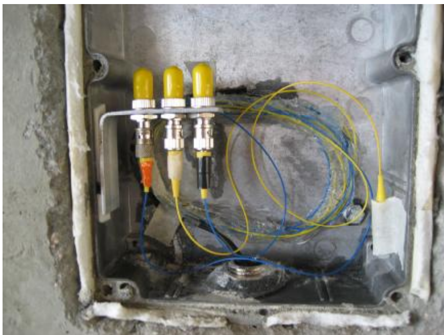
Рис. 2. Разъемы от волоконно-оптического датчика деформаций, залитого в пилоне, выведены в коннекторный блок на поверхность
