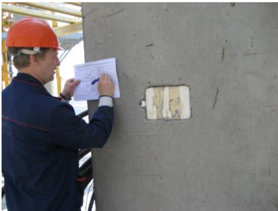
Рис. 1. Датчик деформаций в пилоне: опалубка снята, очередной измерительный узел заносится в реестр системы мониторинга
