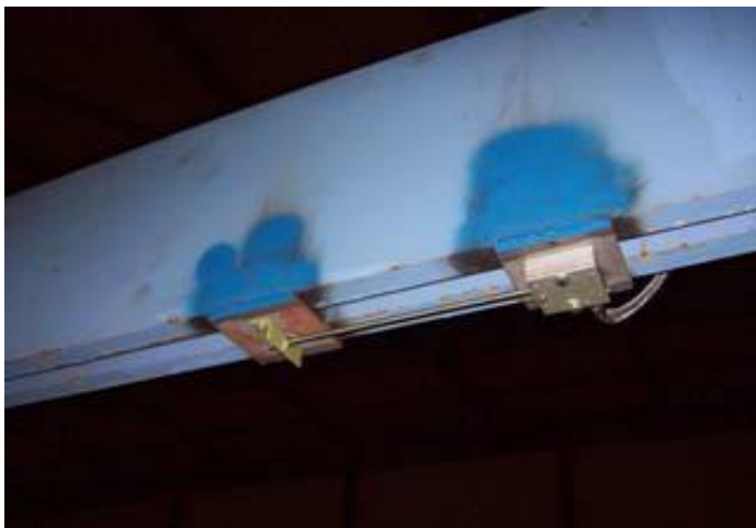
Волоконно-оптический датчик деформаций на арочной ферме
