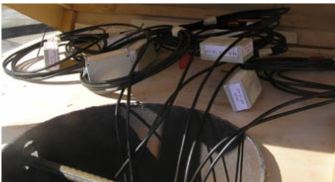
Коммутационные блоки от первых датчиков выведены на стол монтажной штанги
